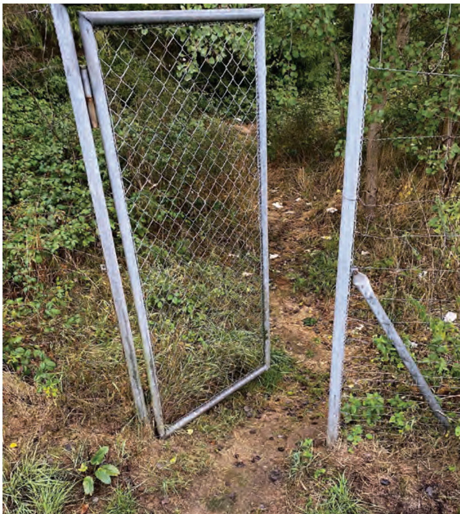
Abb. 5: Nicht mehr schließende Nottür am Parkplatz „Uersfeld“ an der A 48 (© Ph. Richter)
