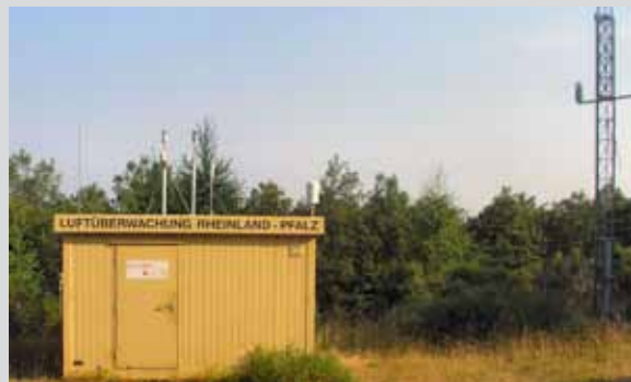
ZIMEN-Messcontainer am Hortenkopf (Umweltkontrollstation Idar-Oberstein, Hunsrück)
